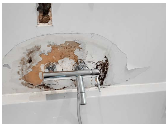
Solche Wasserschäden können ohne die passende Versicherung schnell ins Geld gehen.
